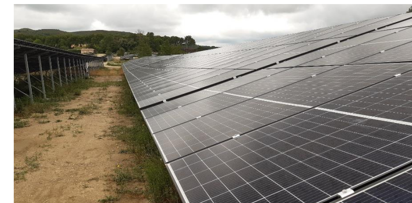
Les structures photovoltaïques s'adaptent à la topographie (source : IDE Environnement)
