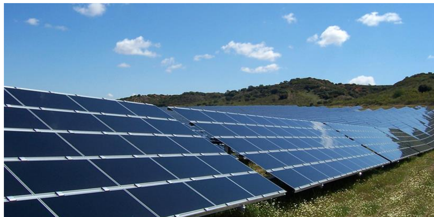
Parc photovoltaïque EDF Renouvelables de Narbonne
